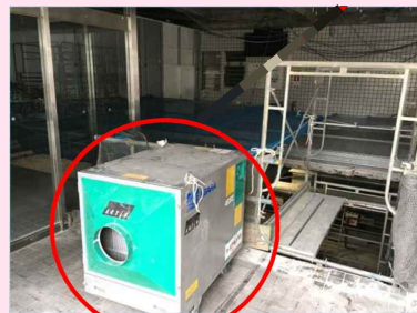
集塵機を設置し室内の換気を実施
