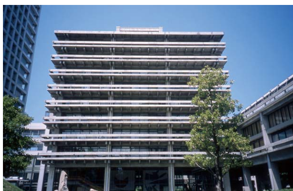
耐震改修着工直前の県庁舎南側外観 二〇一七年七月二一日撮影
